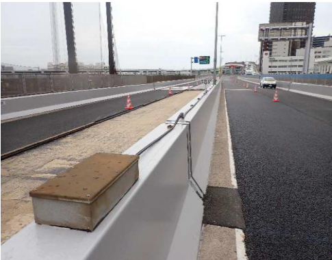
空中線（路側ケーブル）
