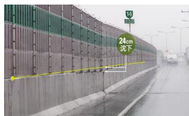
ヒンジ部沈下の状況
