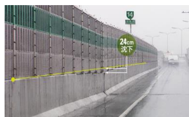
ヒンジ部沈下の状況
