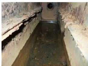
高欄内の滞水 (3号神戸線 府県境付近)
