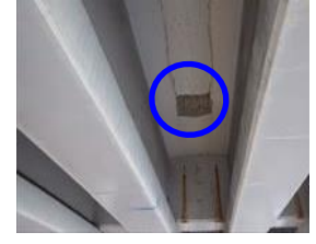
コンクリートの抜け落ち (11号池田線、2018年8月撮影)
