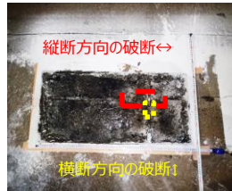
PC鋼材の破断
