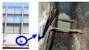
投象防止柵支柱のアンカー部の減肉 (16号大阪港線 阿波座付近)
