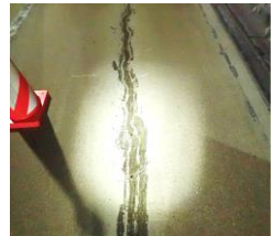
路面のひび割れ
