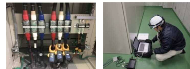
【新技術】 ジェットファンの電流値から電動機内部の正常/異常を判定、吊り金具の異常も検出可能（通行規制無し）
