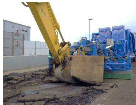
古いアスファルトを電磁波で加熱し、はがすときの騒音を抑えて、夜間帯での工事を実施
