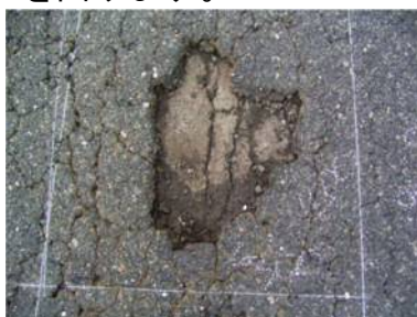
舗装の損傷状況
