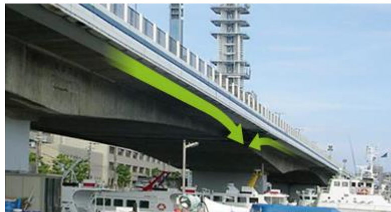
中央部の垂れ下がりが進行する橋桁
