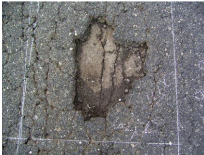
舗装の損傷状況
