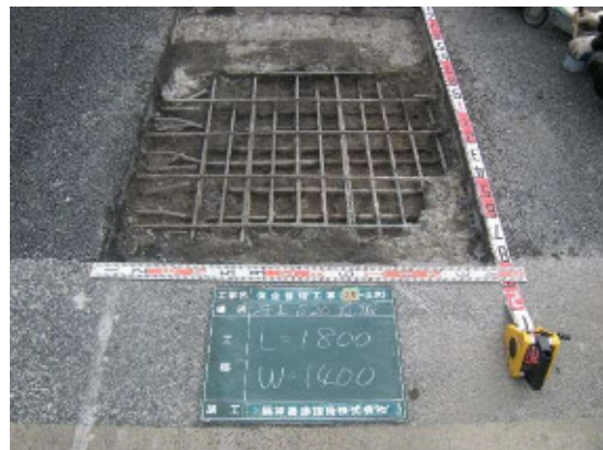
コンクリート床版の深刻な損傷
