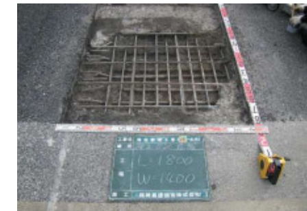
コンクリート床版の損傷 13
