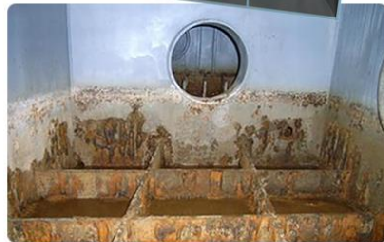
滞水の痕跡が残り腐食が進む鋼製の基礎内部
