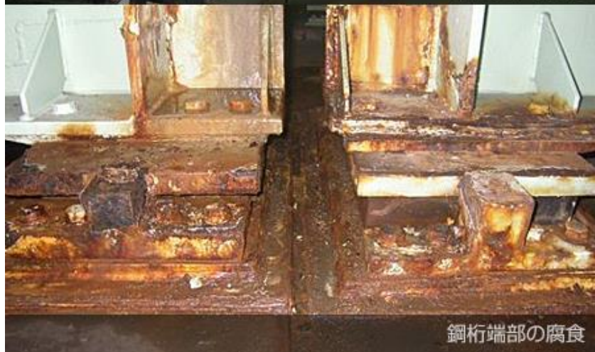
伸縮継手の破損
