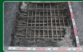
陥没したコンクリート床版
