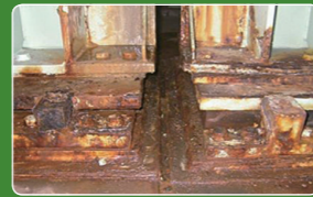
鋼桁端部の腐食
