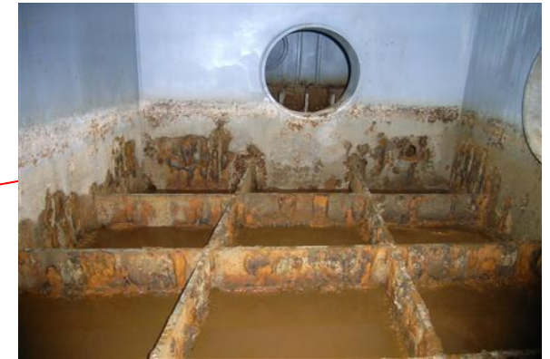
鋼製フーチング内部腐食状況
