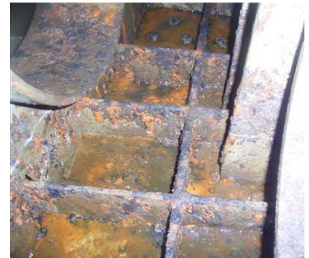
腐食による断面減少
