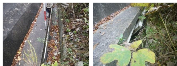
写真-3 のり尻排水溝の変位 左1年前、右1年後
