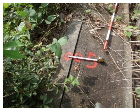
写真-4 のり肩の継ぎ目の開口
