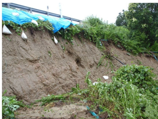
写真-1 法面崩壊状況
