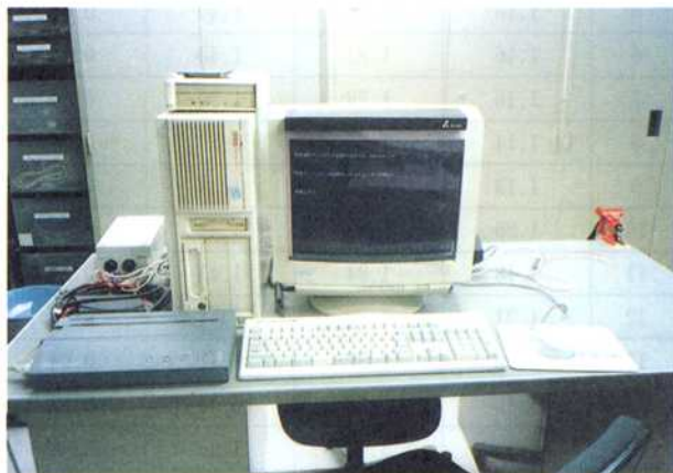
写真2 仮設監視親局装置
