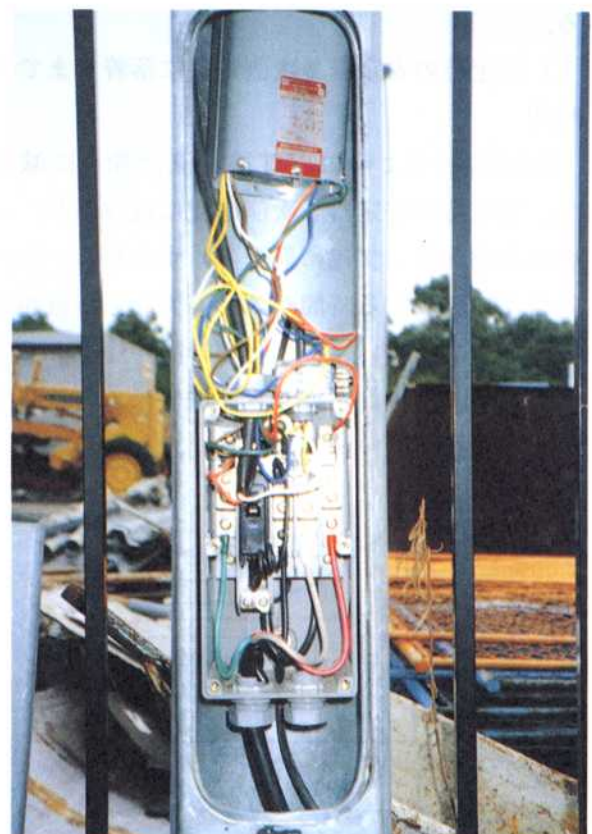
写真1 照明柱内収納の照明灯端末装置
