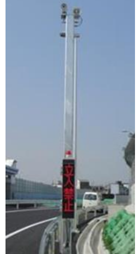
【誤進入対策設置例】
